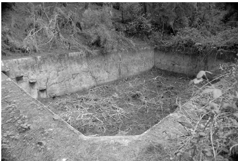
Estanque de Saavedra. Tomadero del Canal Riego de Saavedra
