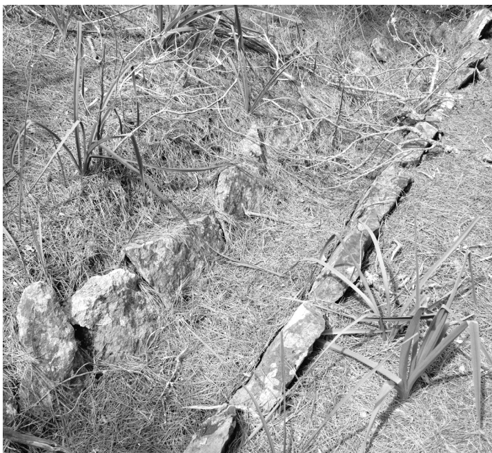
Canal Barranco de Saavedra a Presa de los Rajones
