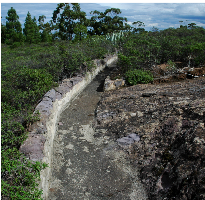
Canal de Los Tesos (Foto Jaime González) entrada de aguas al canal por arroyamiento laminar
